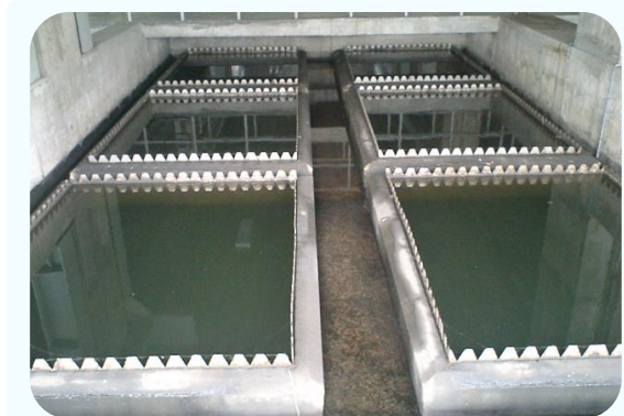
รูปที่ 23 ลักษณะระบบตกตะกอน แบบฝายน้ำล้น
